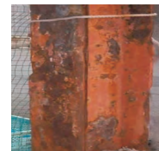
全体的に錆びて 一部欠損が見られた
